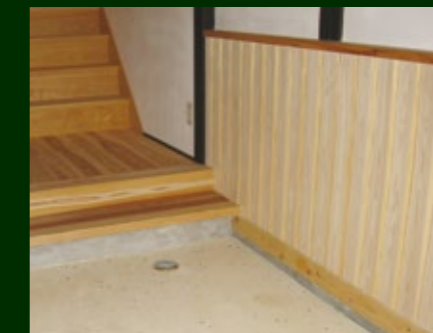
腰板に北山丸太(面皮付板)を使用した玄関の上り框
